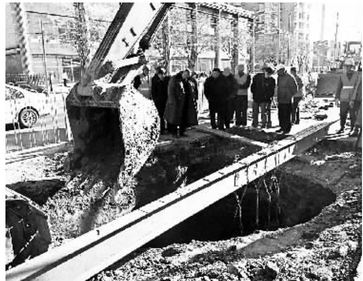
抢险人员刨开路面,寻找破裂水管。首席摄影记者 吴宁/摄
