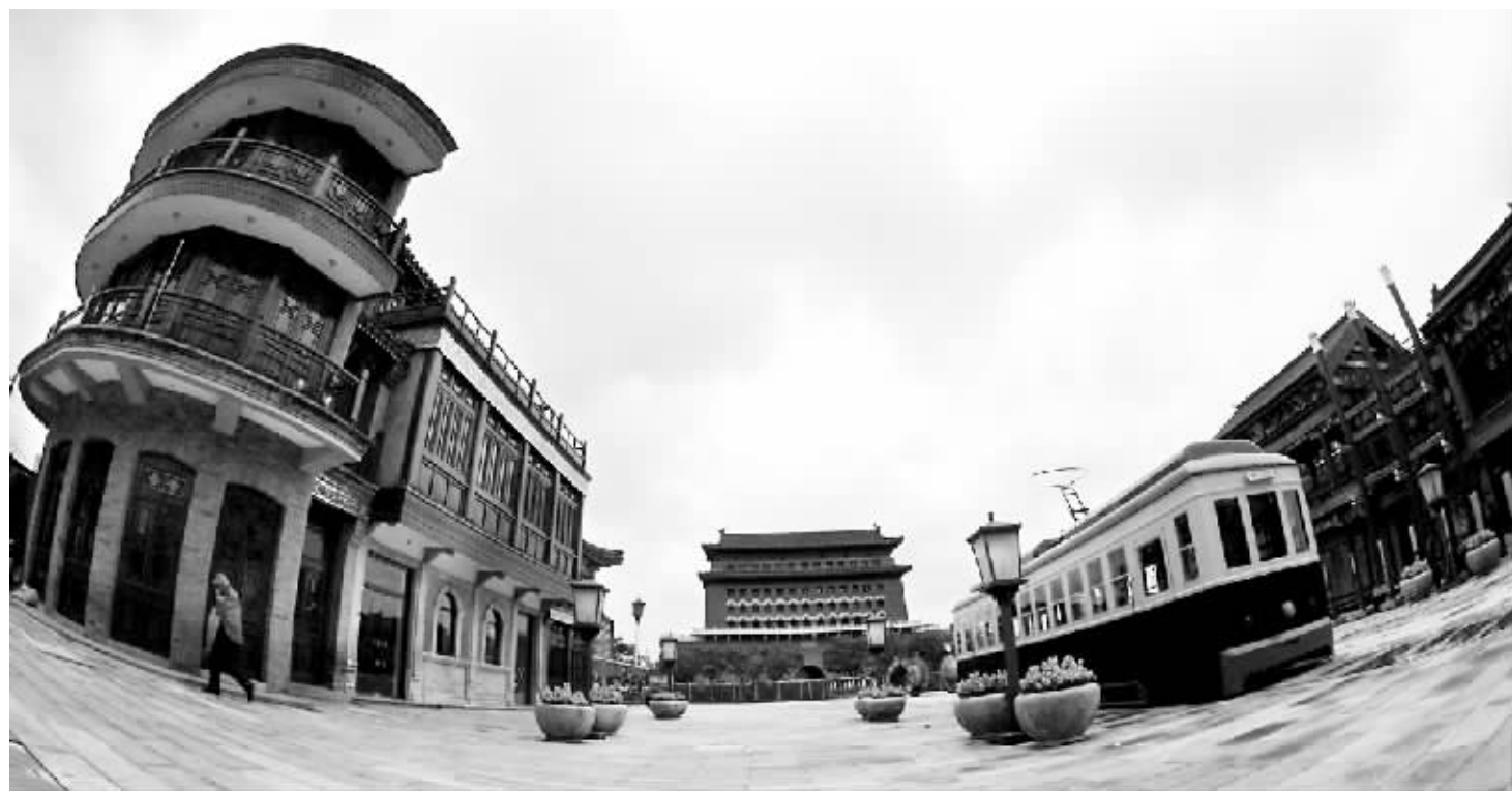
修旧如旧的前门大街整治工程进入收尾阶段,将呈现出全新的面貌。
