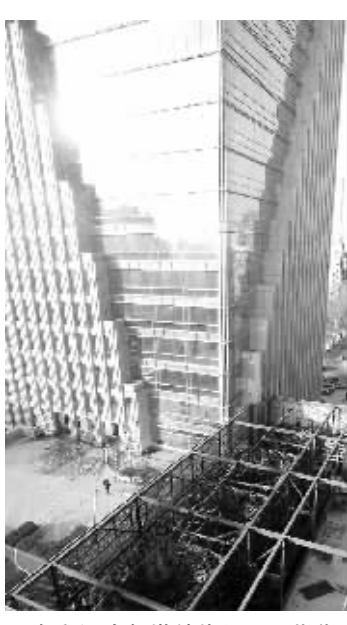
四个空调冷却塔被烧毁。王彬/摄
