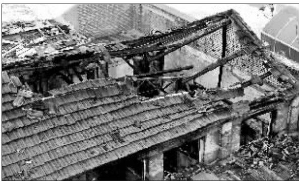
被烧塌的屋顶
